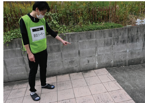
前兆現象と思われる地面のひび割れを発見
